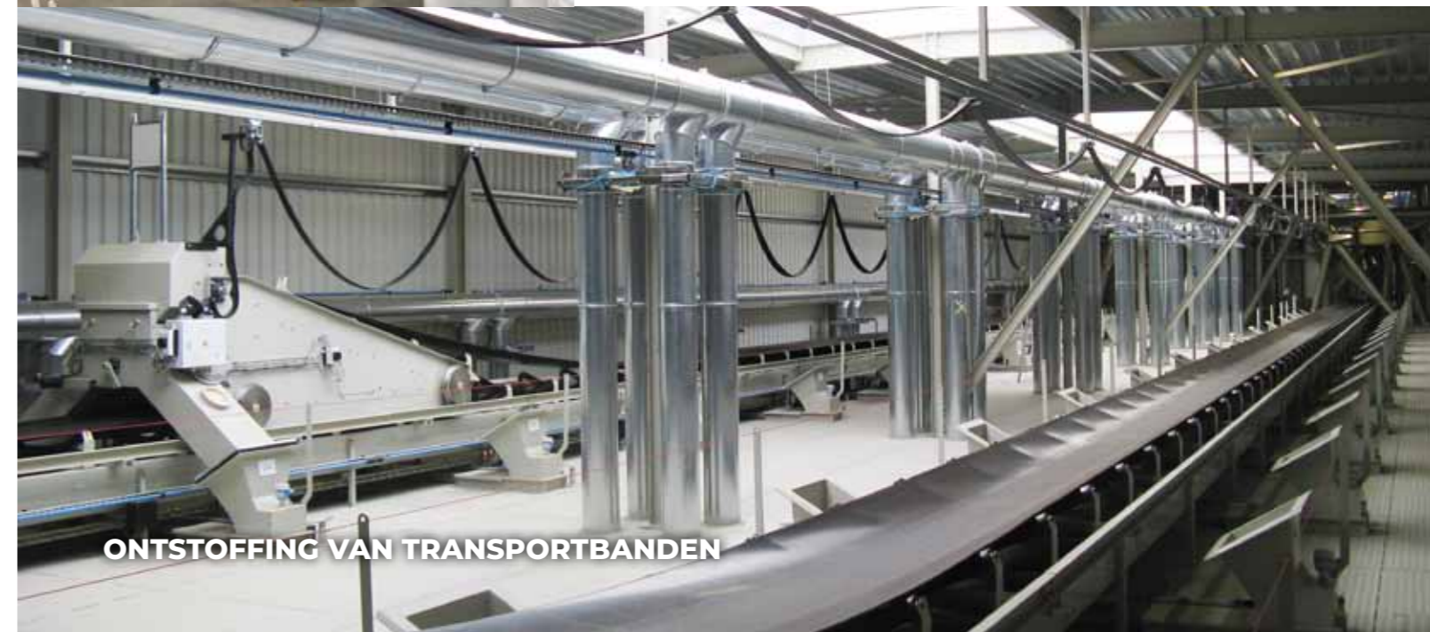
RVS CYCLONEN VOOR DROOGINSTALLATIE
