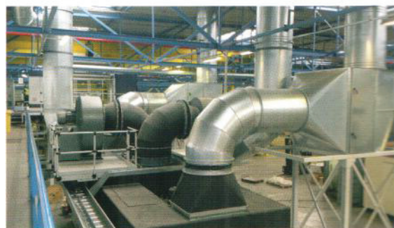
Afb. 3 Enkele van de dertien installaties voor de aanvoer van verse lucht, inclusief filterkasten
