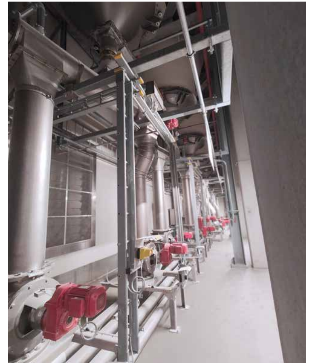
Systemen voor uitval en dosering vanuit de silo's naar pneumatische transporten.
